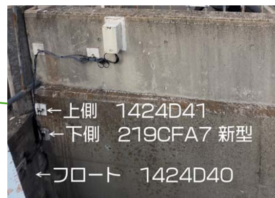
ジョイナス荷捌き場の浸水センサ
