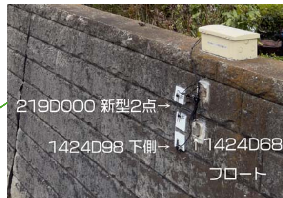
金港橋の浸水センサ
